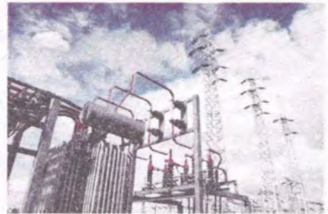
Рис. 32.4. Трансформаторна підстанція поблизу міста
